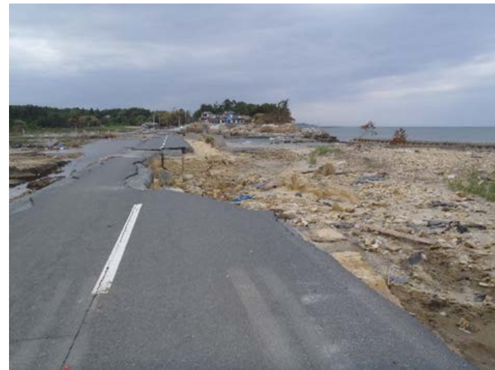
南相馬道路被災状況
